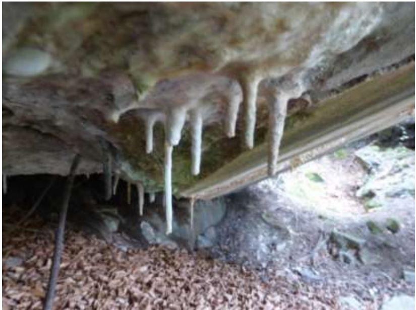
Tropfsteingebilde am verfallenen Bunker
